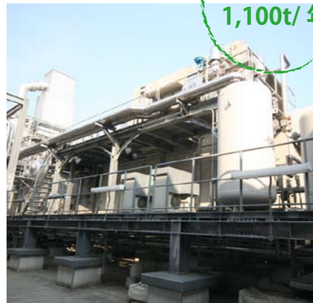
コージェネレーション設備
